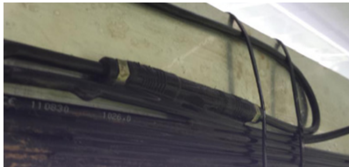
図10: コネクタを架台にびったり固定すると、コネクタとレールの間に湿気が滞り、接続部が破損する可能性があります。
